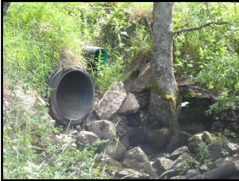
Kuva 22. Lappalaistenojan putket ovat tyhjiillään, sillä vesi on syöplynyt kulkemaan niiden alitse. Kohde on täydellinen kulkueste.
