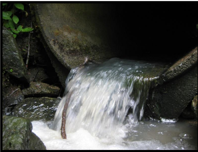
Kuva 11. Preitilän metsäpurrossa sijaitseva tierumpu muodostaa nousuesteen alaosan pudotuksellaan sekä putken pienen vesikorkeuden ja sileän pohjan vuoksi.
