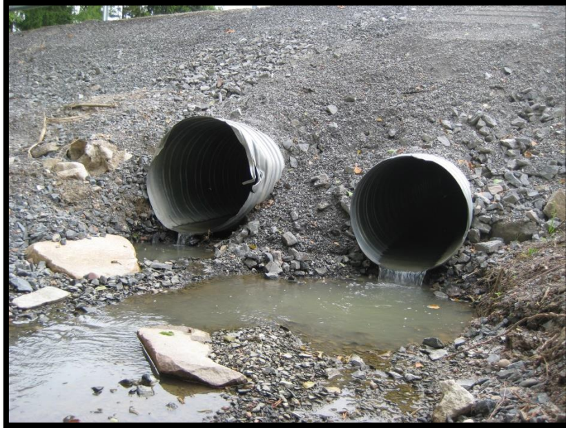
Kuva 25. Koskella tulvien myötä sortunut tie korjattiin ja ratkaisuna oli asentaa toinen tierumpu Kraninojaan. Tierummut muodostavat täydellisen kulkuesteen eliöille.
